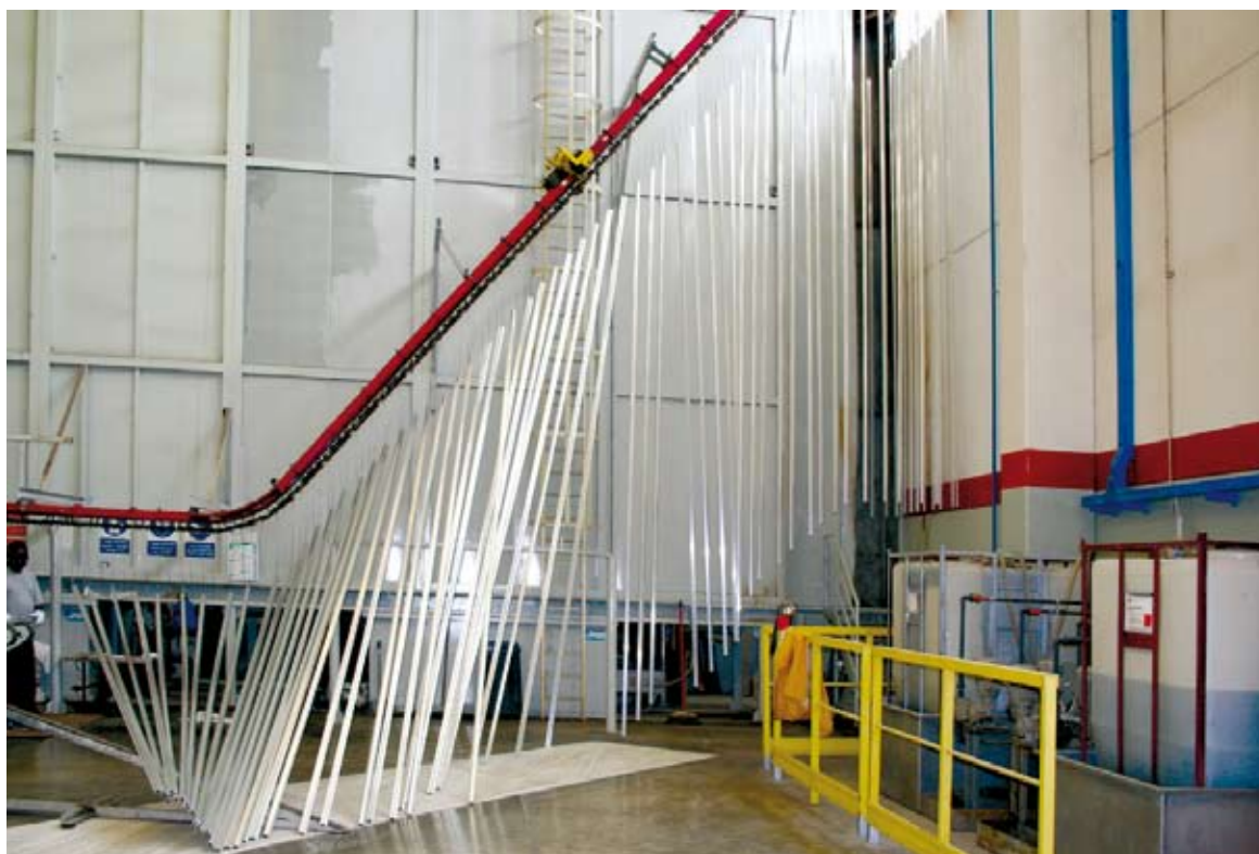
9 - La zona di carico dell'impianto verticale, si notino a destra i serbatoi contenenti i prodotti di pretrattamento.
