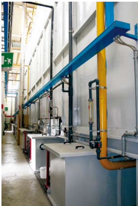
4 - Il tunnel di pretrattamento dell'impianto verticale.
