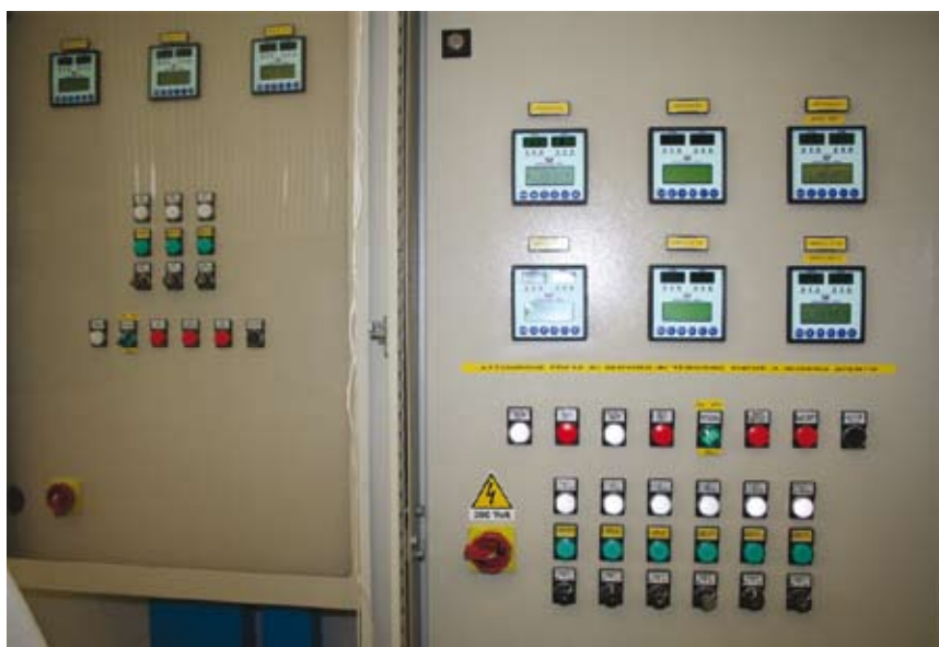
10 - La centralina per il monitoraggio e dosaggio dei prodotti di pretrattamento.
