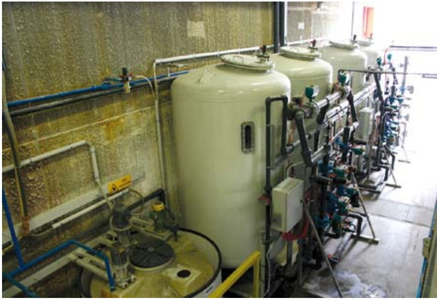
11 - L'impianto di demineralizzazione fornito dalla Ecoteam di Scandicci (Fi).
